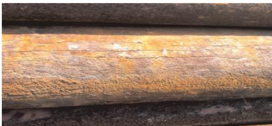
Рис. 2. Тріщини корозійної втомності трубопроводів (після очистки зовнішньої ізоляції)
