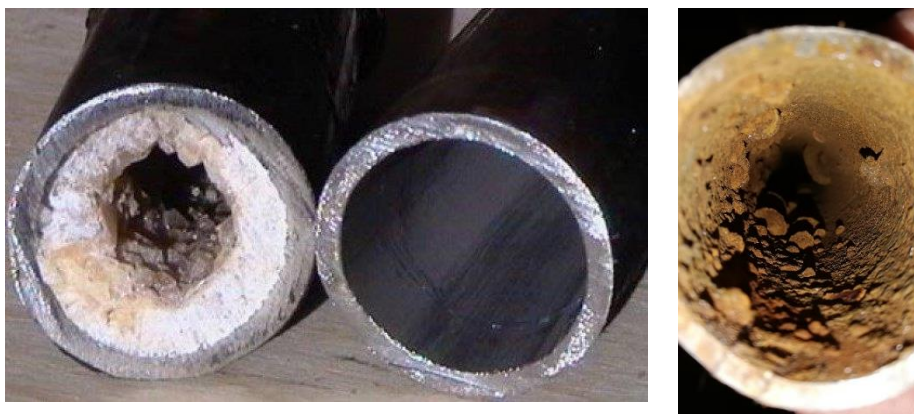
Рис.2. Приклади внутрішнього мікробіального обростання трубопроводів Fig.2. Examples of internal microbial fouling of pipelines
