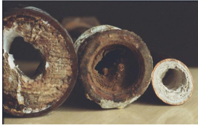
Рис.3. Закупорка трубопроводу внаслідок мікробіологічного обростання Fig.3. Clogging of the pipeline due to microbiological fouling.
