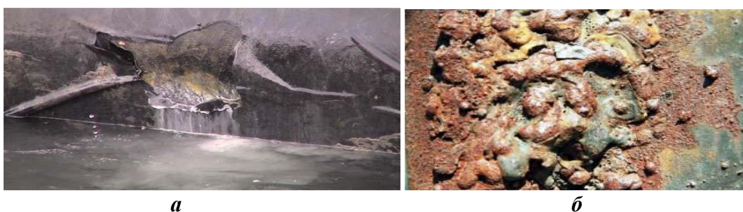
Рис. 2. Підплівочна корозія поверхні сталевій опорній конструкції (а) та мікробіологічна корозія поверхні спіральної камери ГЕС (б)
