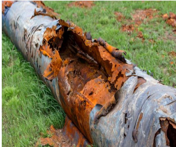
Рис. 1. Корозійно-механічні ушкодження з подальшим руйнуванням підземного водоводу тривалого терміну експлуатації (40 років)
