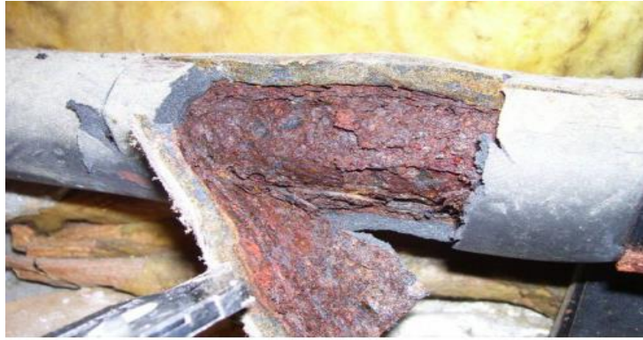
Рис. 3. Ушкодження ізоляційно-утеплюючого покриття водоводу міського водопостачання (термін експлуатації – 30 років)
