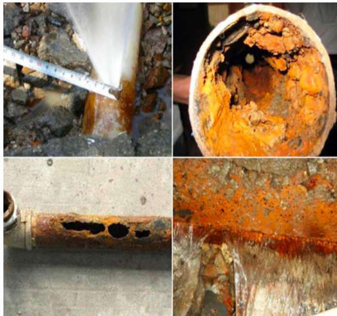
Рис. 2. Фрагменти руйнувань різних ділянок водоводу з тривалими термінами експлуатації
