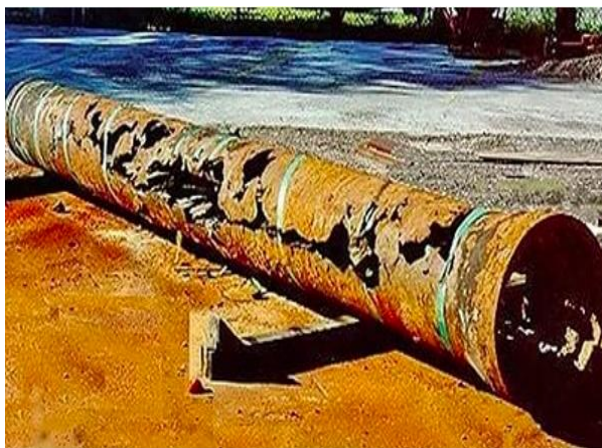
Рис. 8. Технічний стан чавунної труби системи водопостачання (термін експлуатації – 50 років)
