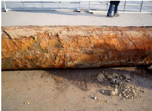
Рис. 7. Зовнішній вигляд підземного трубопроводу з постачання гарячої води споживачам (діаметр 420 мм; термін експлуатації 40 років)
