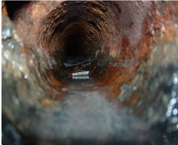
Рис. 6. Внутрішній технічний стан підземної каналізації з відводу стічних вод на очисні споруди
