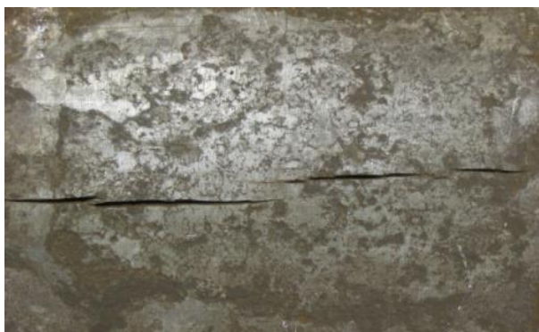
Рис. 4. Магістральна мікротріщина в тілі корпусної конструкції водонапірної башти. Корпусна сталь марки ВСт3 (термін експлуатації 40 років)
