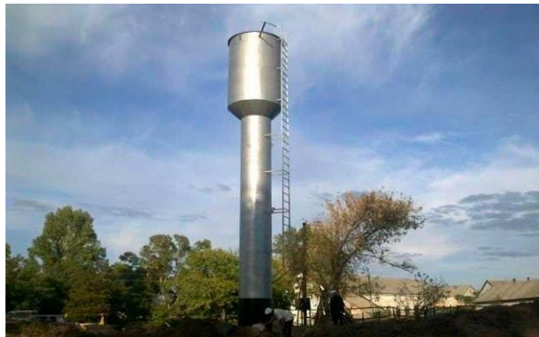
Рис. 8. Водонапірна сталева башта: ємність запасу води V = 50 \text{ м}^3 ; висота опорної труби H = 24 \text{ м} ; висота заливної ємності h = 9 \text{ м} ; діаметр заливного баку D = 4 \text{ м}
