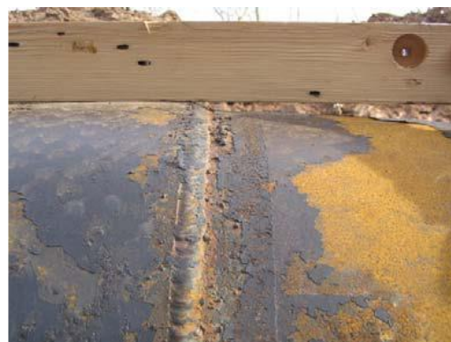
Рис. 2. Загальний вид корозійного ураження поверхні пішохідного проходу по мостовій конструкції на ділянці зруйнованої ізоляції
