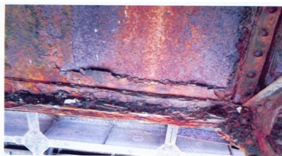
Рис. 1. Корозія опорної сталеві конструкції водонапірної башти
