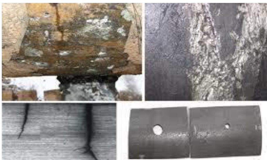
Рис. 3. Корозія металоконструкцій водонапірних башт (термін експлуатації 30-40 років)
