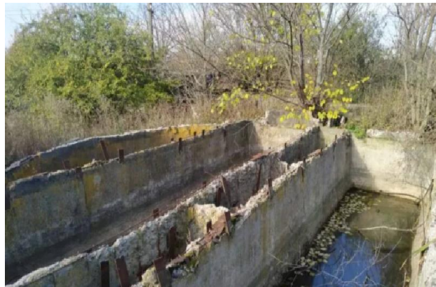
Рис. 1. Зруйновані каналізаційні очисні споруди
